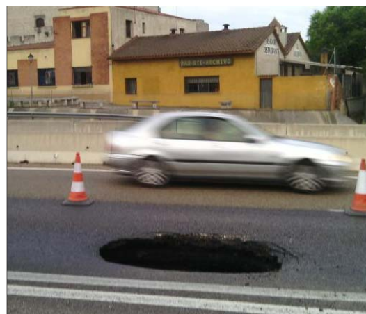
Socavón en uno de los carriles de la A-62 a la altura de Simancas. L. DE LA FUENTE
